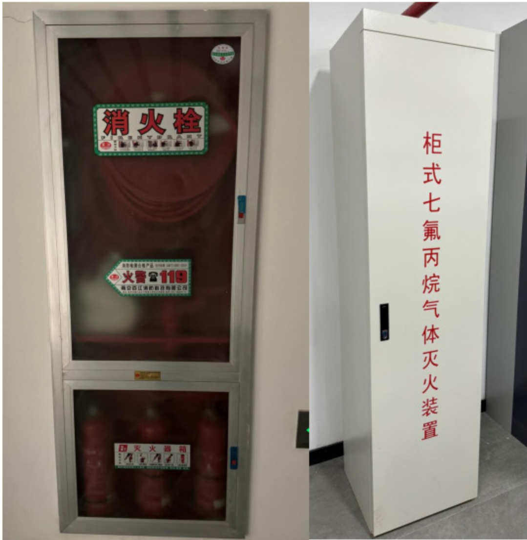
南京城墙博物馆文物库房消防设施
